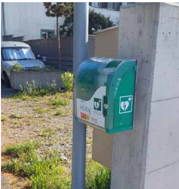
AED-Standort beim Notausgang beim Tunnel in Bickwil.
