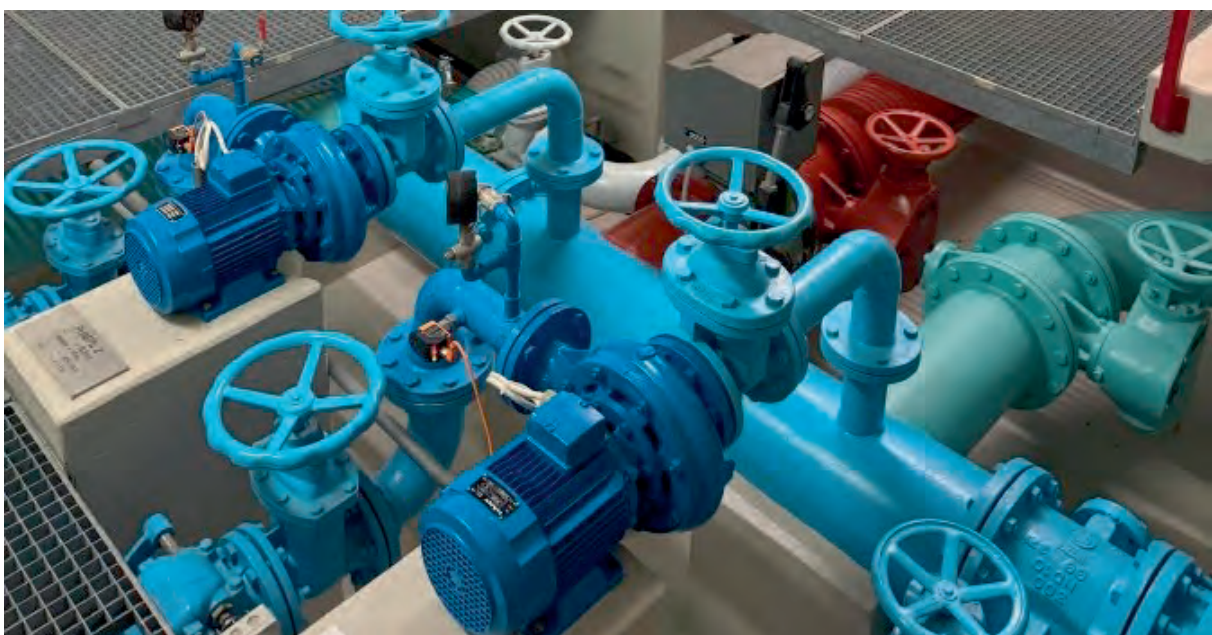
Einblick in die Pumpanlagen des Reservoir Isenberg, das im Rahmen des GWP ausgebaut werden soll.
