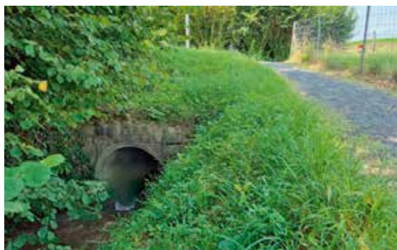
Der betroffene Bachdurchlass bei der Räschraste.
